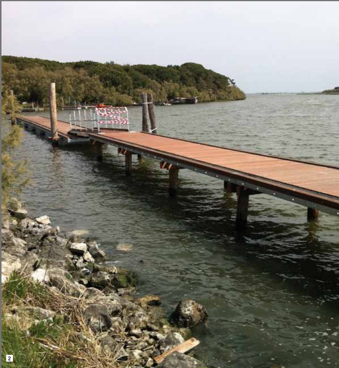
1,2/ Nelle foto, realizzazione di pontile fisso su pali e pontile galleggiante con passerella di raccordo all'interno dell'Oasi del Parco Naturale del Delta del Po a Comacchio
